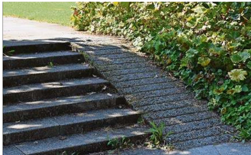
Die bestehenden Rampen konnten ohne Hilfe nicht benutzt werden.
